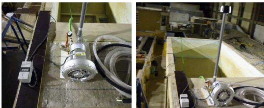
Figuras 14 e 15 . Compressor montado em placa colocada sobre o depósito do canal pequeno. São visíveis o disjuntor e a válvula de esfera montada na saída by-pass (fotografia esquerda) e o tubo de admissão com filtro de ar (fotografia direita).
