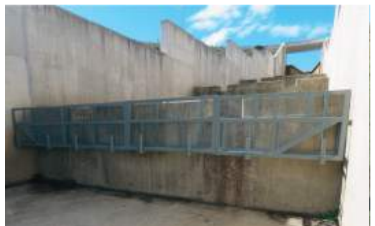
Estrutura com 4 cestos metálicos no descarregador de cheia.
